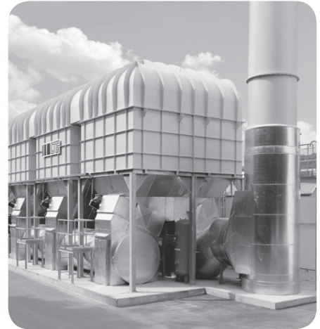
Установка очистки и регенерации газа
